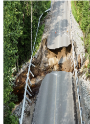
route coupée par un affaissement
